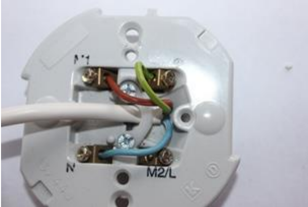
Ledningerne tilsluttet lampestedet
